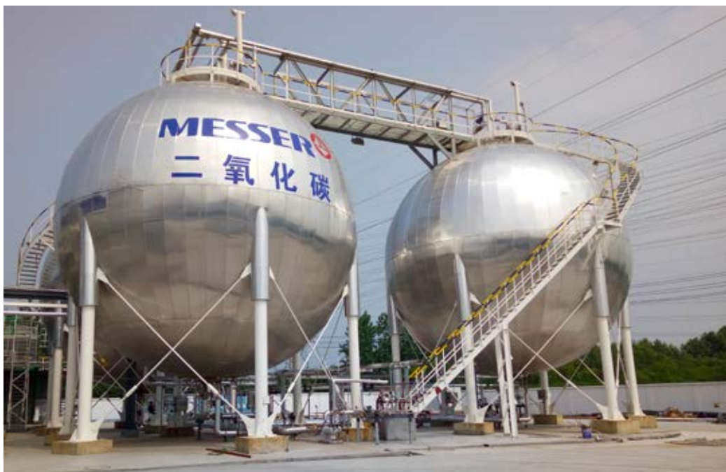
Aufbereitetes CO 2 wird in speziellen Tanks gespeichert. Abnehmer sind die Lebensmittel-, Getränke- und chemische Industrie oder die Landwirtschaft.
