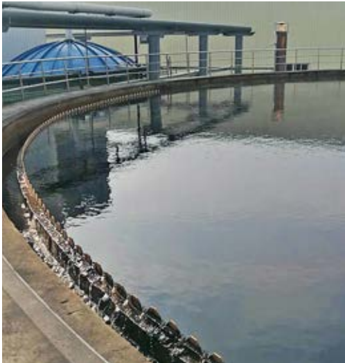
Durch Zugabe von Kohlendioxid lässt sich der pH-Wert von Industrieabwässern in solchen Klärbecken äußerst präzise einstellen.
